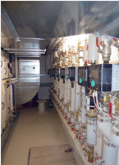
Abb. 4: Ansicht Haustechnikverteilerzimmerraum (Steirereck GmbH)
